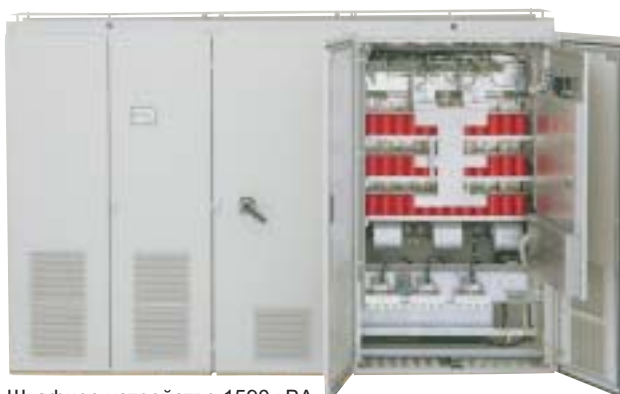
Шкафное устройство 1590 кВА
